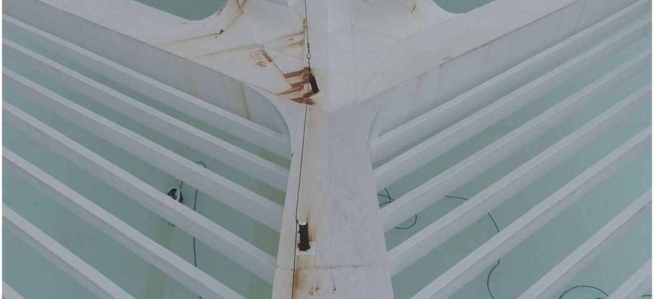
FOTO 55 – CORROSÃO ACENTUADA SUPORTE DE LINHA DE VIDA
