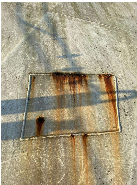
FOTO 72 – DETALHE CORROSÃO NA SOLDA ENTRE CHAPAS DE COBERTURA
