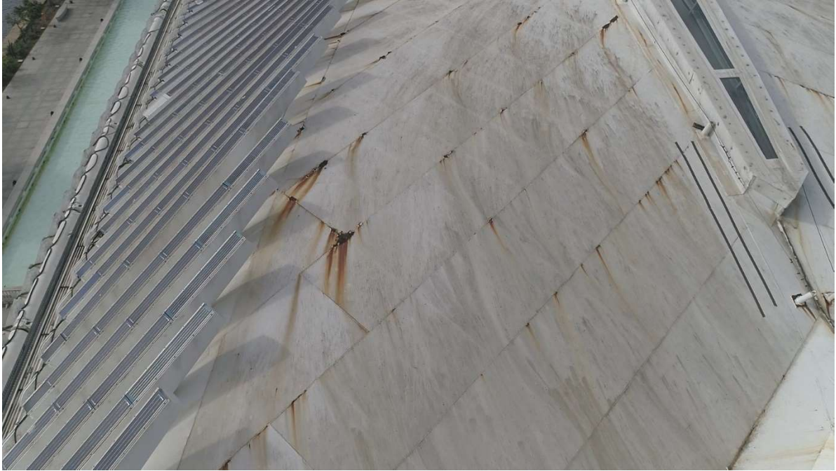
FOTO 57 – CORROSÃO GENERALIZADA NAS SOLDAS ENTRE CHAPAS DE COBERTURA
