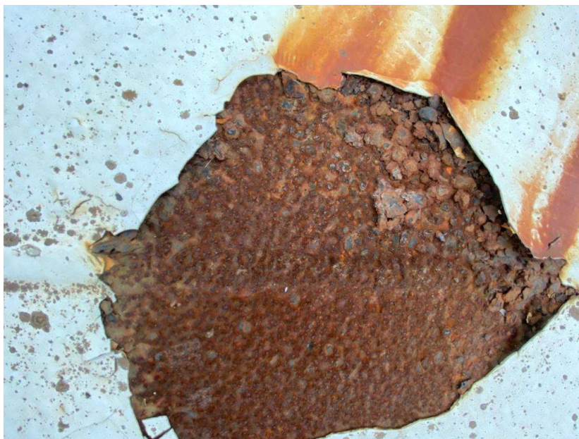
DETALHE DA CORROSÃO AVANÇADA – GRAUS C e D
