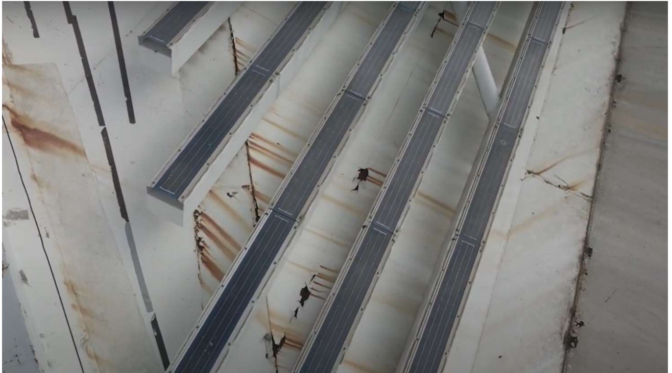
FOTO 59 – CORROSÃO GENERALIZADA NAS SOLDAS
